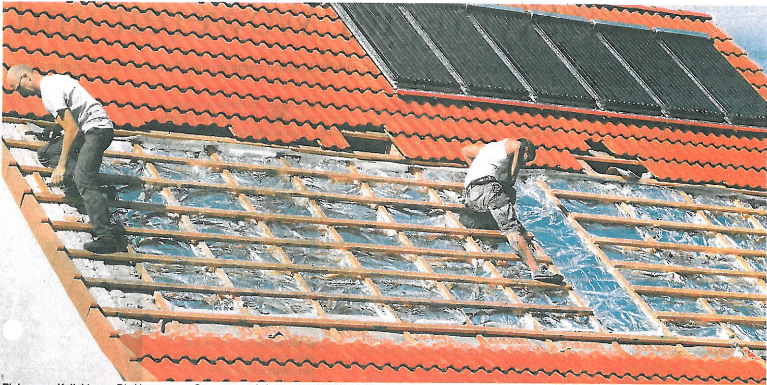
Einbau von Kollektoren: Die Nutzung von Sonnenenergie ist – neben Wind und Biomasse – ein Schwerpunktthema für die geplante Schule.
